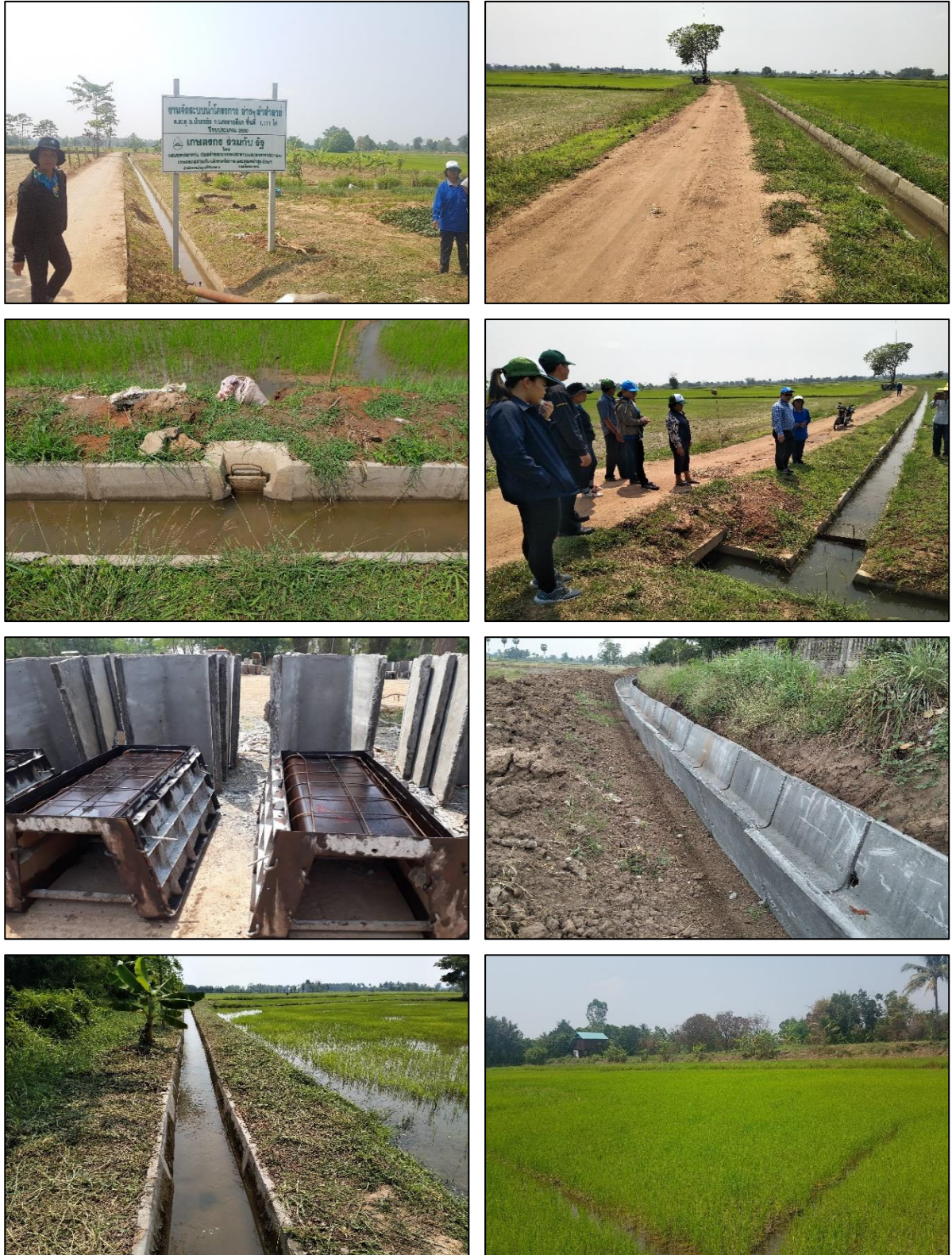
ภาพที่ 3.4 งานจัดระบบน้ำ โครงการอ่างเก็บน้ำลำลำลาย จังหวัดนครราชสีมา ที่มา : จากการสำรวจ, 2561
